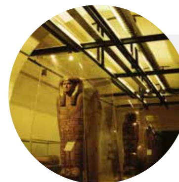
Castello Sforzesco Milano Impianti meccanici e sistema di regolazione, controllo e supervisione dei parametri funzionali e del microclima.
